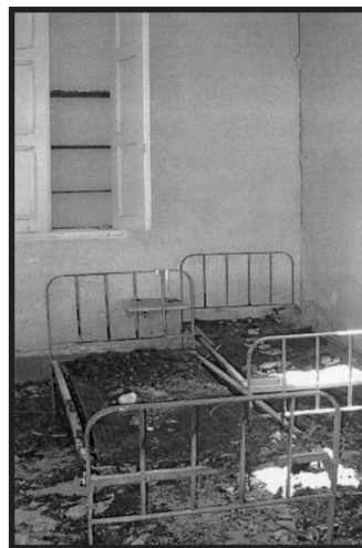
Situación de deterioro de las salas del sanatorio
